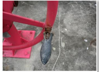
予定箇所③ 現況写真 (ハンドル老朽化状況)
