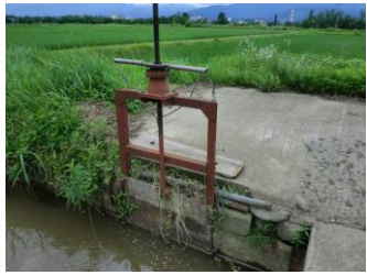
予定箇所① 現況写真 (ゲート老朽化状況)
