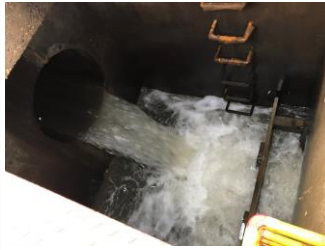
予定箇所② 現況写真 (仕切板破損状況)
